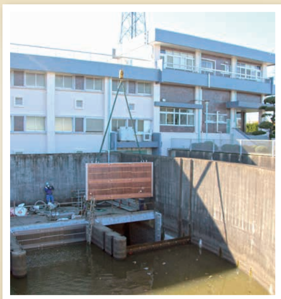
船戸揚水機場銅製スクリーン (カワヒバリ貝付着防止のため)
