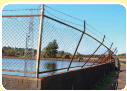
返田揚水機場フェンス傾倒
